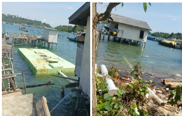
Gambar 2. Sistem Pengolahan Tinja Komunal Wilayah Pesisir yang mengalami kebocoran, timbulan bau dan penyumbatan
